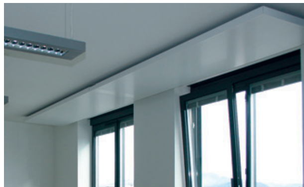
Topně-chladicí panely Spektra O použité jako zónový prvek u fasády.
