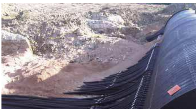
Spojovací potrubí na rozdělovací šachtě v horizontální konstrukci
