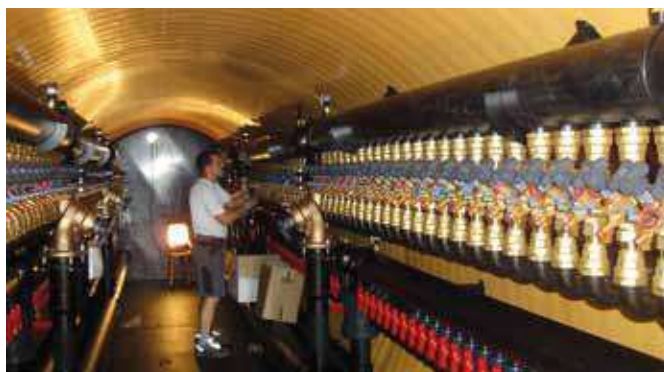
Rozdělovací komponenty v rozdělovací šachtě
